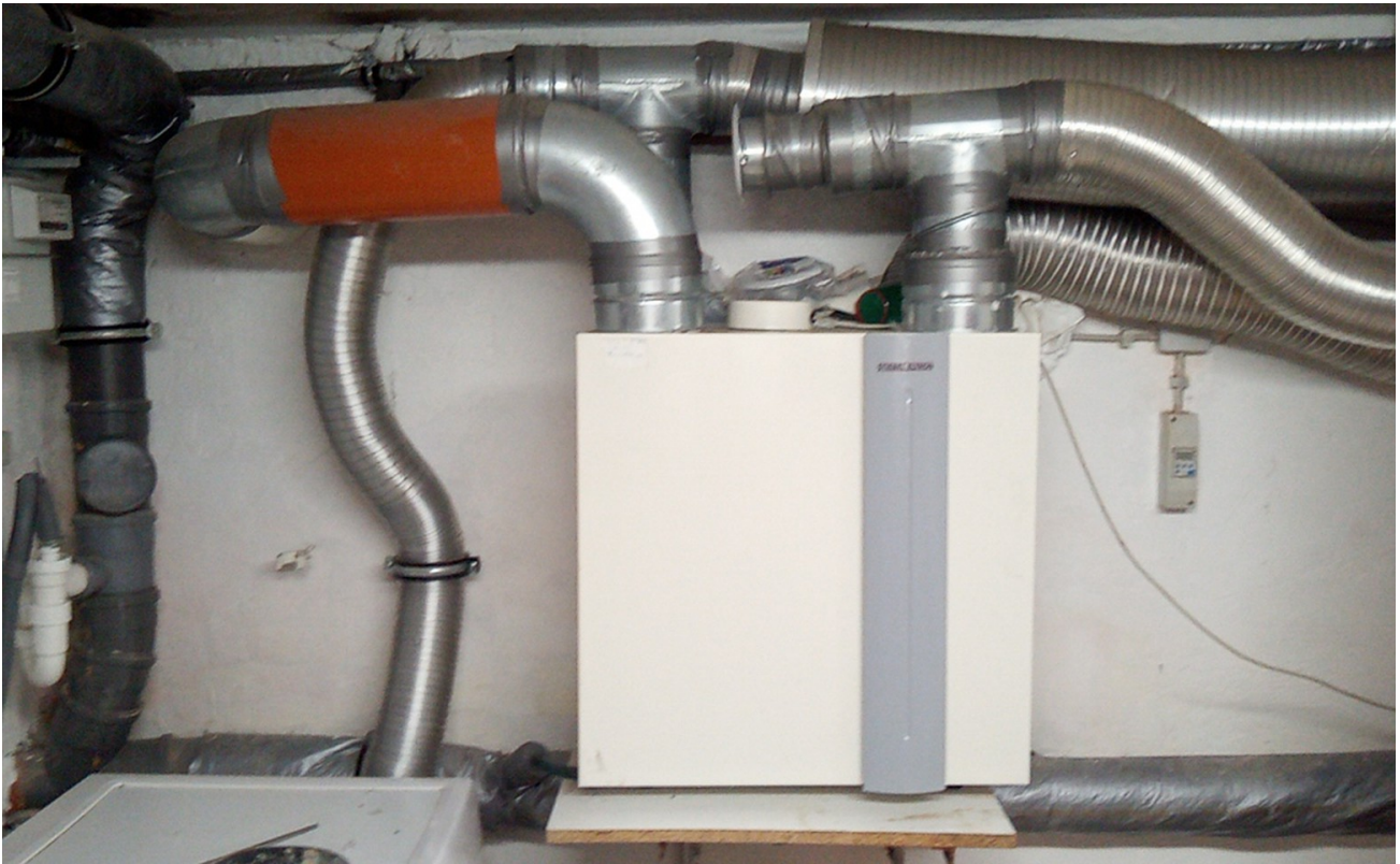
Lüftungsanl. m. Schalldämpfer
