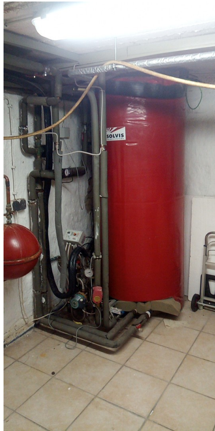
Solarspeicher Keller Nord-Ost
